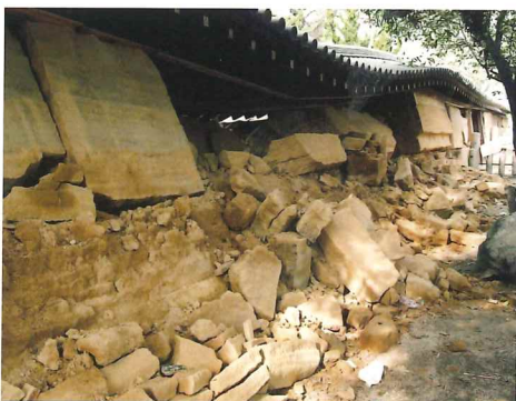
震災により全壊した大練塀
